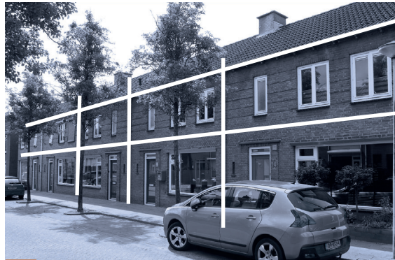
1 Gaten in metselwerk
