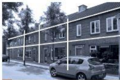
1 Gaten in metselwerk
