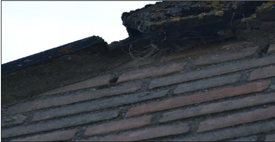
Figuur: dergelijke kieren bij nokpannen kunnen toegang bieden tot ruimtes onder het dak. Hier kunnen gierzwaluwen nestelen.
