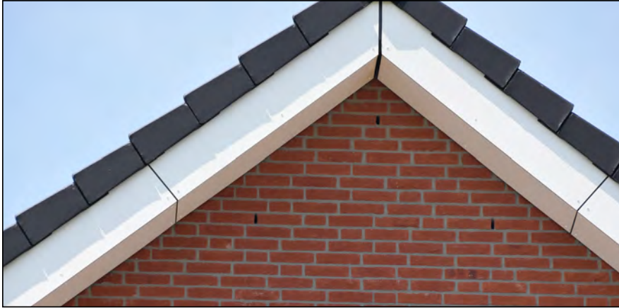
Figuur: in de nieuwbouwwoningen ten westen van het plangebied zijn open stootvoegen aanwezig die leiden naar de spouw. Hierin kunnen vleermuizen verblijfplaatsen hebben. Ook kunnen gierzwaluwen nestelen onder de nokpannen.
