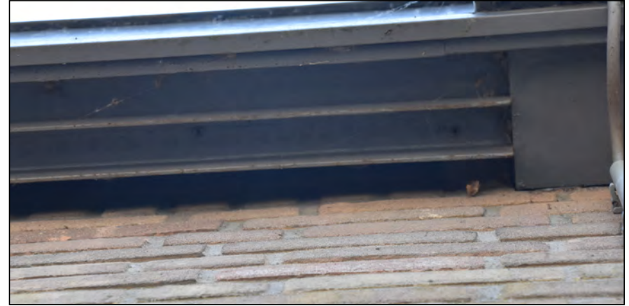
Figuur: dergelijke openingen en kieren achter plaatmateriaal kunnen toegang bieden tot ruimtes onder het dak of tot de spouw. Hier kunnen gierzwaluwen nestelen of vleermuizen verblijfplaatsen hebben.
