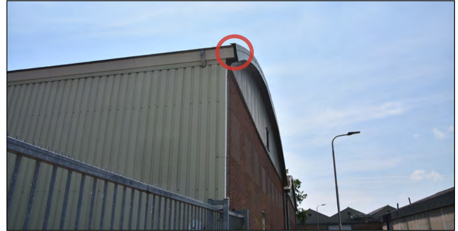
Figuur: bij enkele van de gebouwen zijn openingen ontstaan door ontbrekende stukken plaatmateriaal. Hier kunnen diverse vogelsoorten in nestelen, zoals bijvoorbeeld spreeuw.
