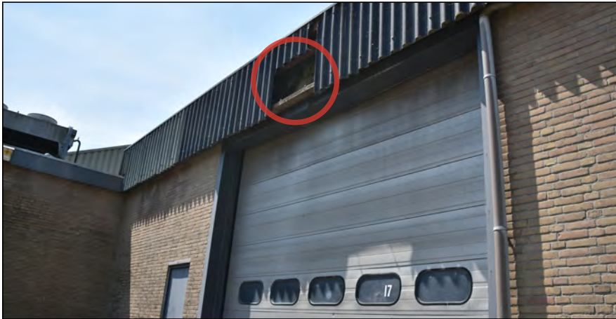
Figuur: bij enkele van de gebouwen zijn openingen ontstaan door ontbrekende stukken plaatmateriaal. Hier kunnen diverse vogelsoorten in nestelen.
